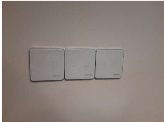
Gambar 10. Smart wall switch pada rumah tinggal tipe Bruce (Sumber: Dokumentasi Penulis, 2023)
