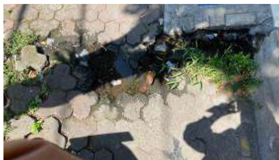
Gambar 3. Kondisi Paving Pedestrian Kawasan Kembang Jepun. (Sumber: Aishnnada, 2023).
